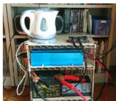
ベランダ発電の室内機
